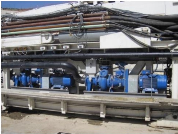
شکل ۸. تجهیزات سیستم پمپاژ انتقال آب از جبهه کار حفاری Fig. 8. Equipment to pumping system from the tunnel face
